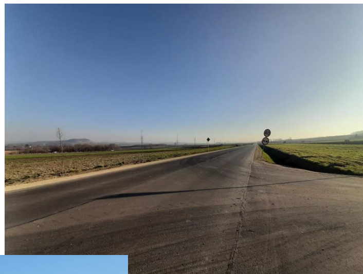
Fot. 9 Jezdnia 885 km 0+600.
