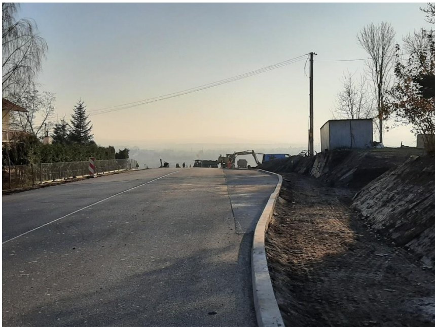
Fot. 23 Jezdnia 885 km 5+920.
