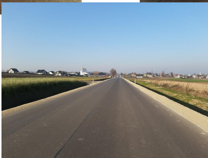
Fot. 8 Jezdnia 885 km 0+700.
